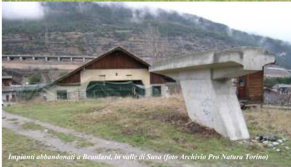
Ruderi di costruzioni mai terminate a Pian Gelassa (foto Archivio Pro Natura Torino)
